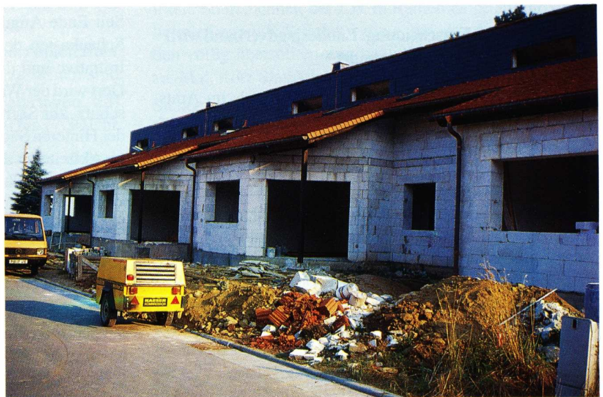
In Struppen-Siedlung entstehen für die Gegend untypische Reihenhäuser im Außenbereich. Die dafür notwendige Abstimmung mit der Nationalparkverwaltung unterblieb. Foto: P.Rölke
