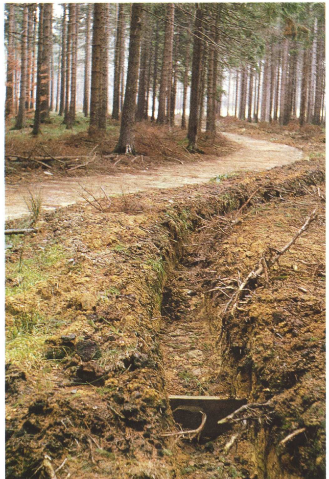
Tiefe Gräben mit zerhackten Wurzeln sind am Kleinen Winterberg vorzufinden Foto: Klaus Kallweit
