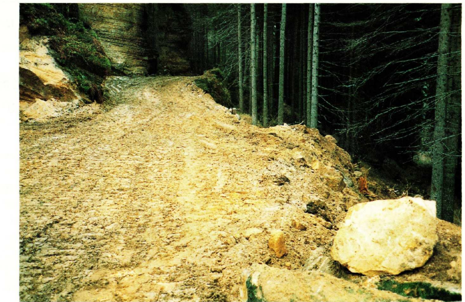
Warum wurde der Wormsbergweg im Bielatal zur breiten Fahrstraße ausgebaut?
