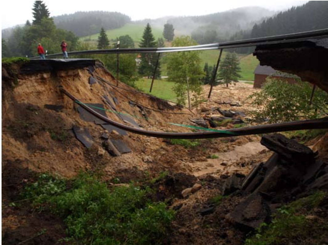
Große Schäden werden am nächsten Tag sichtbar: Die Straße nach Hinterhermsdorf ist zerstört. (Foto: Frank Strohbach, Hinterhermsdorf)
