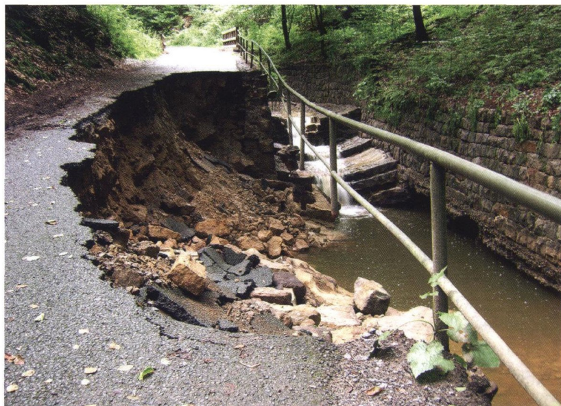
Zerstörungen an der Straße im Wehlener Grund
