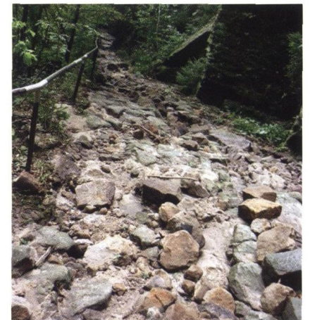
Bild rechts: starke Zerstörungen kurz oberhalb der Amsel-fallbaude (mit Blick abwärts);
