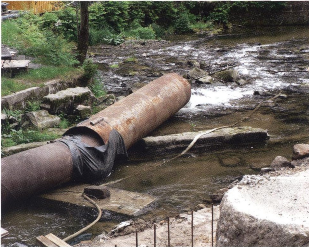
Bild 3: Ende des Rohrs an der Neumannmühle. Die Improvisation ist unübersehbar.
