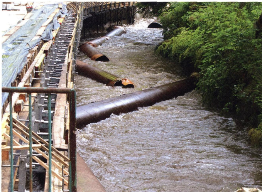
Bild 9: ... und wie die Rohrleitung am Lichtenhainer Wasserfall danach aussah
