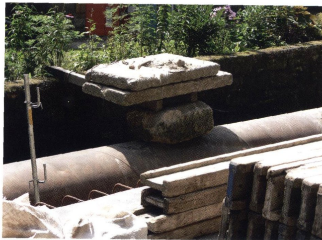
Bild 7: Hochwassersichere „Verankerung“ eines Rohrstücks?
