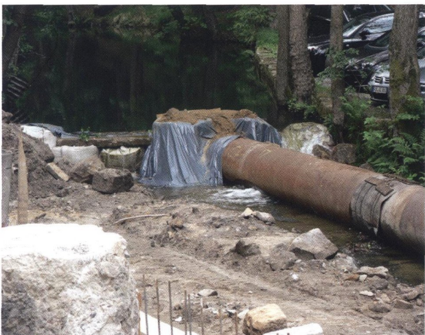
Bild 5: Damm an der Neumannmühle – mehr als provisorisch!
