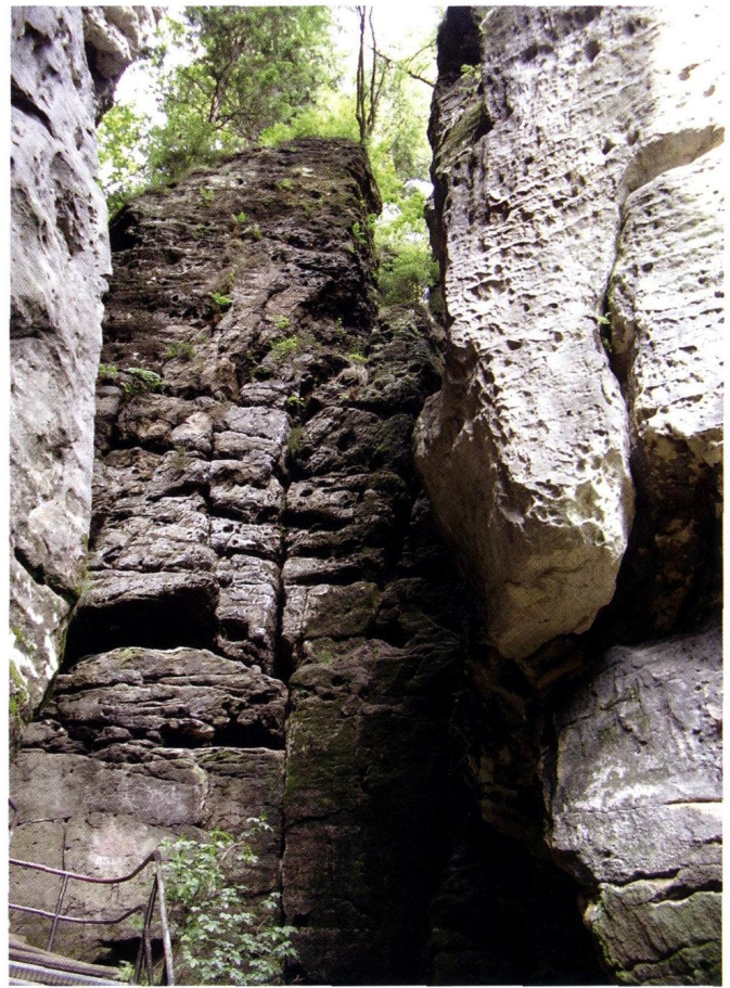
Blick von unten auf den Felspfeiler, der auf den vielbegangenen Wanderweg durch die Schwedenlöcher abzustürzen drohte.
