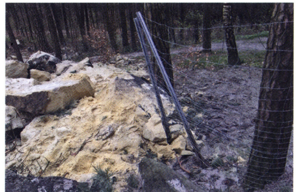
Schäden des Felssturzes auf der sanierten Fläche
