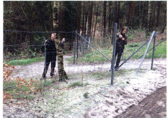
Zaun zum Erosionsschutz am Rauenstein
