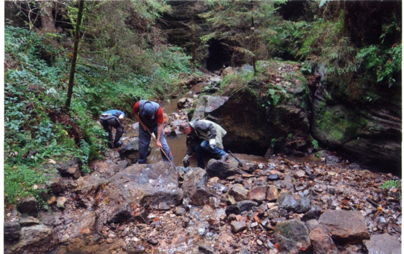
Arbeiten im Gelobtbachgrund nach den Starkregenschäden
